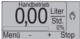
Abb. 24: Startanzeige der Dosierpumpe nach Erstinbetriebnahme
